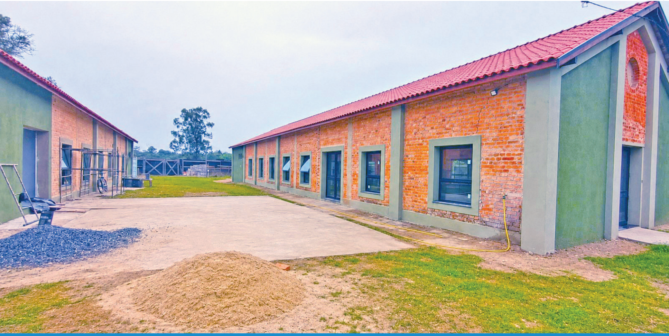
O projeto prevê investimento total de R$ 2,8 milhões para execução das obras, viabilizado por meio da Lei Rouanet, dos quais R$ 1,5 milhão foi destinado pela Novelis
