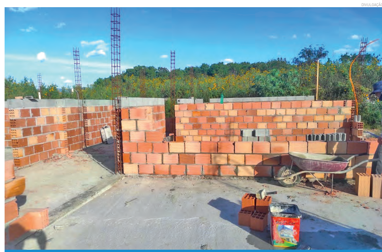
O CER Parque das Palmeiras fica em uma área com cerca de 5 mil m 2 e terá 1.847 m 2 de área construída
