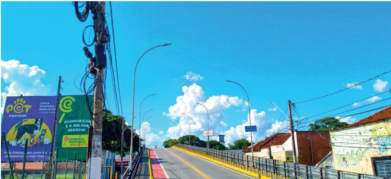
Trecho do viaduto central está entre os pontos identificados pela EDP com fiação irregular a ser retirada no mutirão
