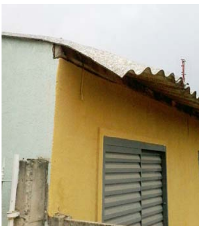
TELHADO DAS CASAS DO LIBERDADE I ESTÃO COM PROBLEMAS DESDE A ENTREGA DOS IMÓVEIS
