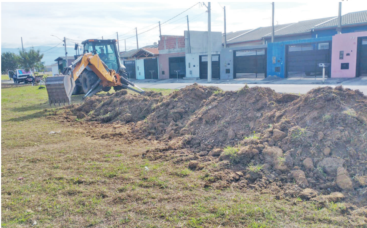
Praça terá área total de 2.414m² e calçamento externo com piso drenante em cerca de 410 m²
