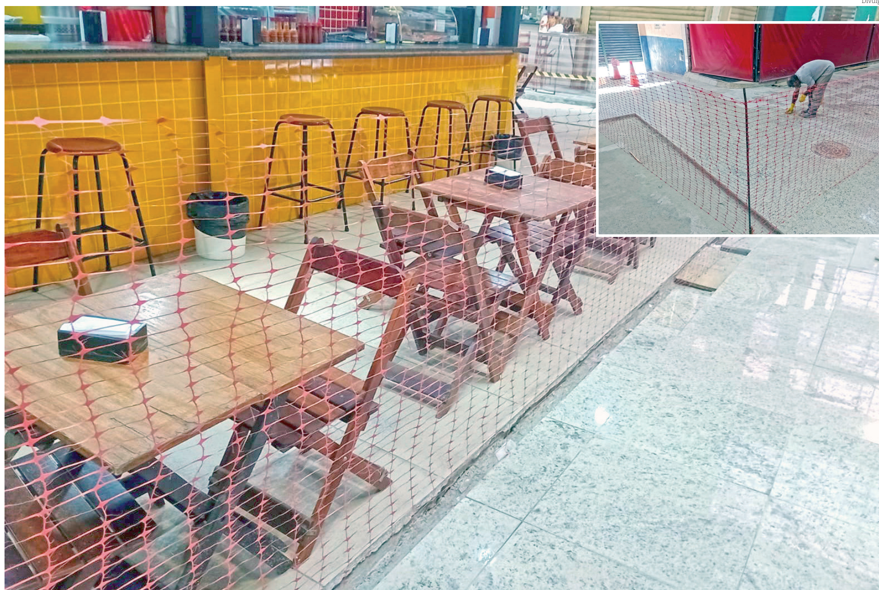
O término da obra está prevista para ainda este mês, quando os comerciantes terão de adequar suas calçadas ao novo piso central
