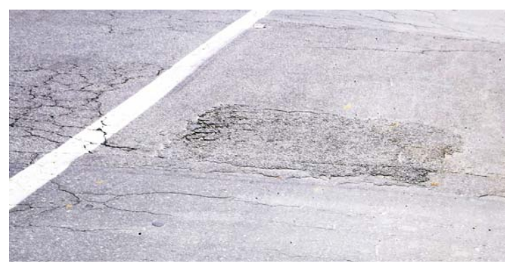
O VEREADOR CAL QUER QUE O DER FAÇA OS REPAROS URGENTES NO ASFALTO DA RODOVIA SP – 62
