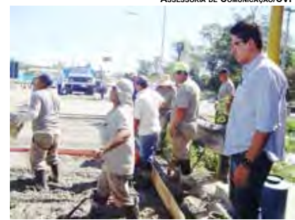
MAGRÃO OBSERVA TRABALHO DOS FUNCIONÁRIOS DA PREFEITURA NO RECAPEAMENTO DO ASFALTO DO PEDÁGIO DA SP 62
