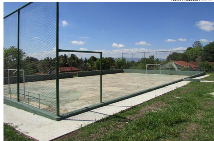
Falta apenas a pintura do piso da quadra para o término da obra
