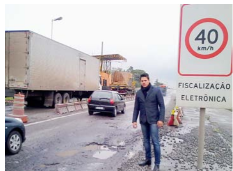
SITUAÇÃO PRECÁRIA DO PAVIMENTO ASFÁLTICO NO PEDÁGIO PREOCUPA VEREADOR MAGRÃO
