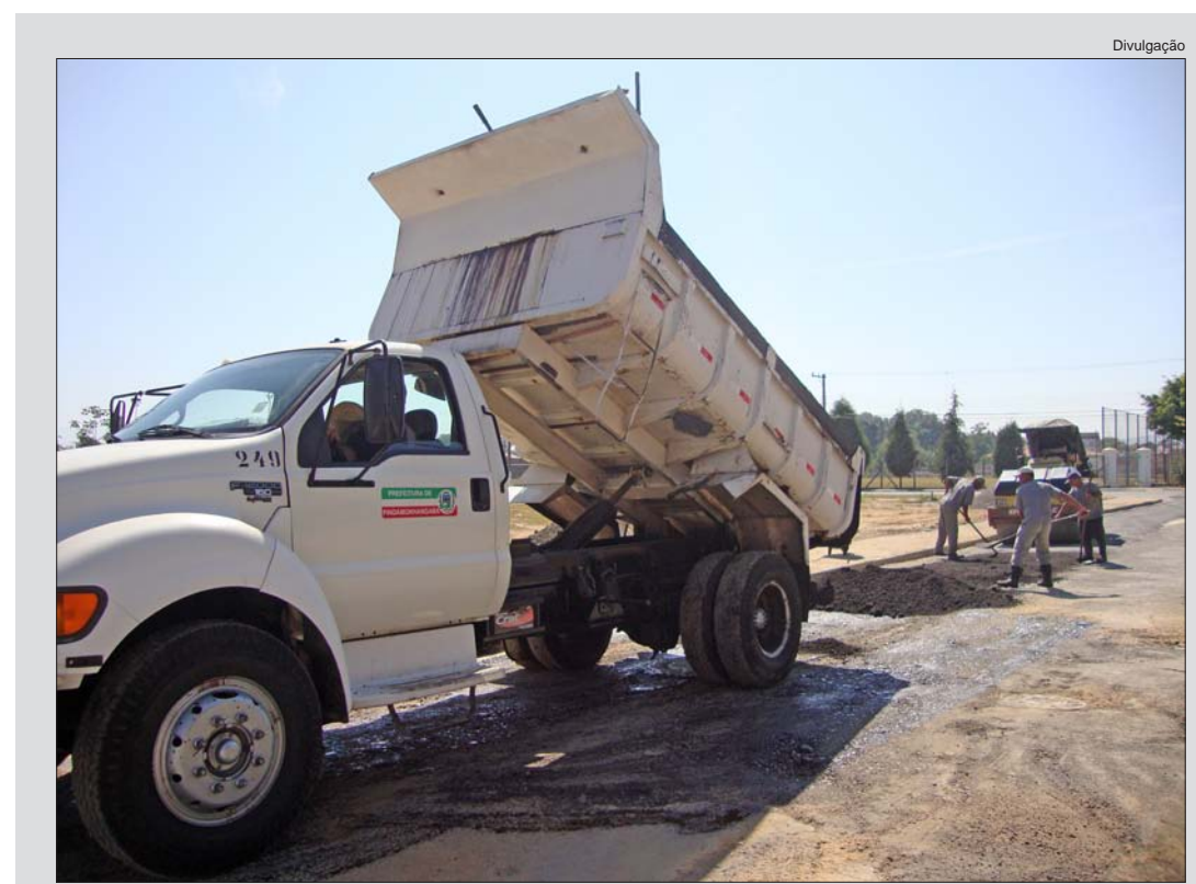
Após o término da galeria de águas pluviais o local está recebendo asfalto
