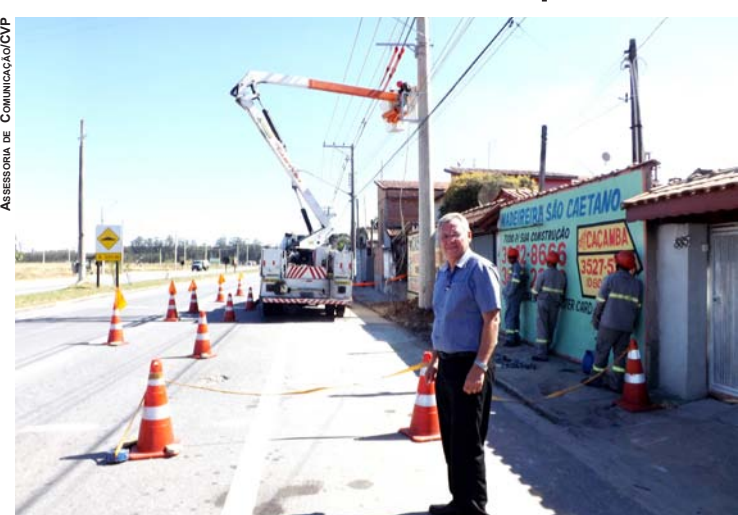
VEREADOR CAL ACOMPANHOU OS TRABALHOS DA EDP BANDEIRANTE PARA LEVAR ENERGIA ELÉTRICA AO PORTAL DOS EUCALIPTOS
