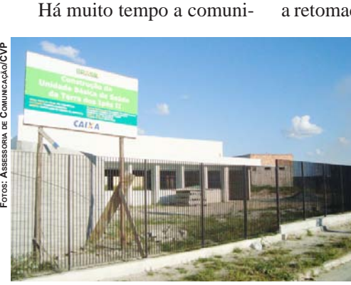
POSTO DE SAÚDE DO BAIRRO TERRA DOS IPÊS II: OBRAS TAMBÉM ESTÃO PARALISADAS
