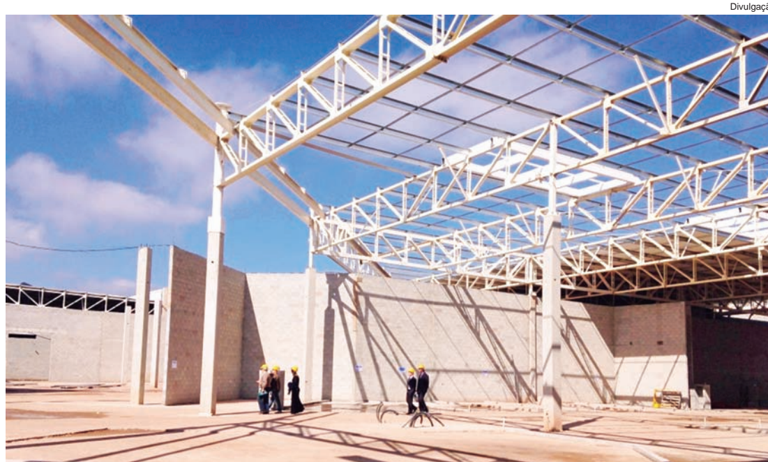
Em construção no bairro do Socorro, shopping terá 33 mil m² de área construída e aproximadamente 150 opções de compra entre lojas e restaurantes
