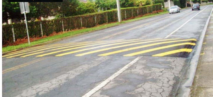
VEREADOR JANIO (DESTAQUE) REGISTRA SEU AGRADECIMENTO PELA CONSTRUÇÃO DAS LOMBADAS NO SOCORRO
