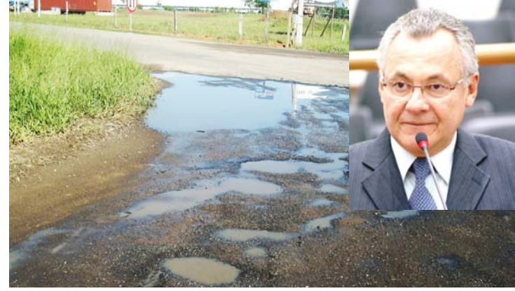
VEREADOR CAL (DESTAQUE) CONSTATOU QUE O RECAPEAMENTO É URGENTE E NECESSÁRIO NA RODOVIA ENG. DUMONT VILLARES; DER INFORMOU QUE OBRAS DEVEM COMEÇAR EM BREVE
