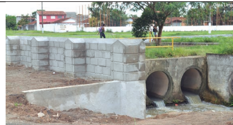
A ponte sofreu danos devido às chuvas de janeiro
