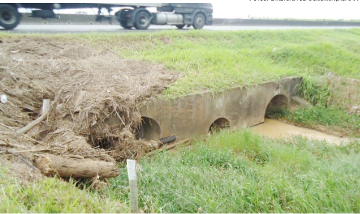
VEREADOR PROFESSOR ERIC CONSTATOU MANILHAS OBRSTUIDAS, DIFICULTANDO O ESCOAMENTO DA ÁGUA
