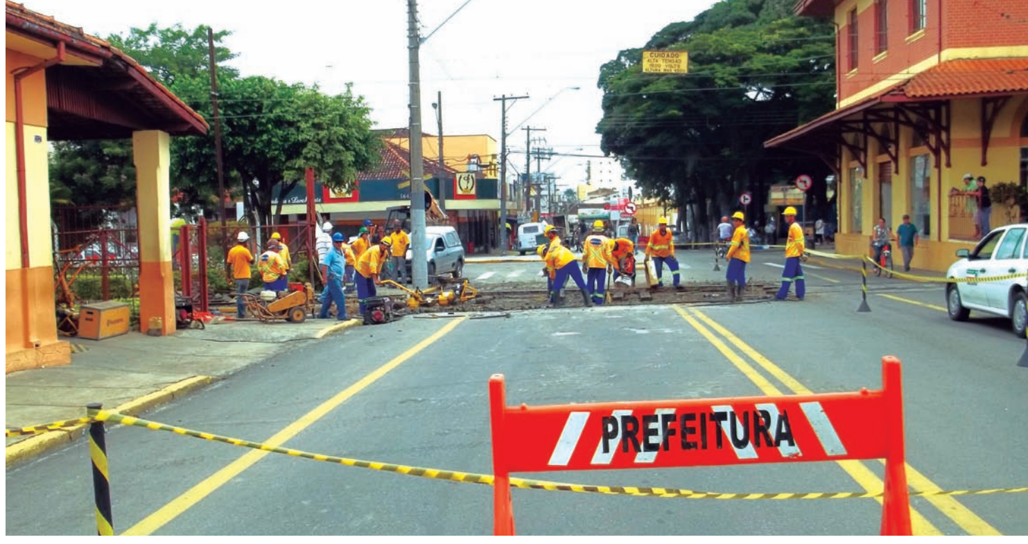
Prefeitura sinalizou rua, que é uma das mais movimentadas da cidade, para reparos nos trilhos da Estrada de Ferro
