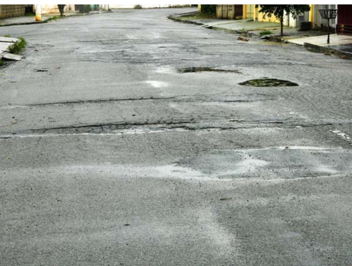
TRECHO DA RUA ALFREDO MOLINARI, NO RESIDENCIAL ANDRADE, COM BURACOS
