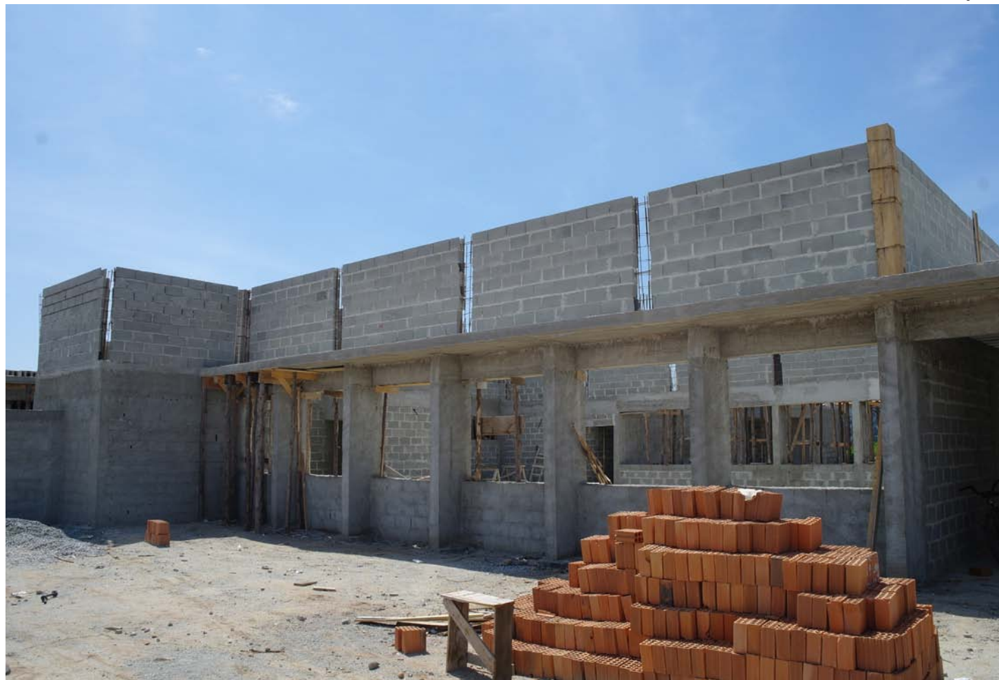
No bairro do Ipê II, Distrito de Moreira César, a obra da nova UBS está em estágio avançado
