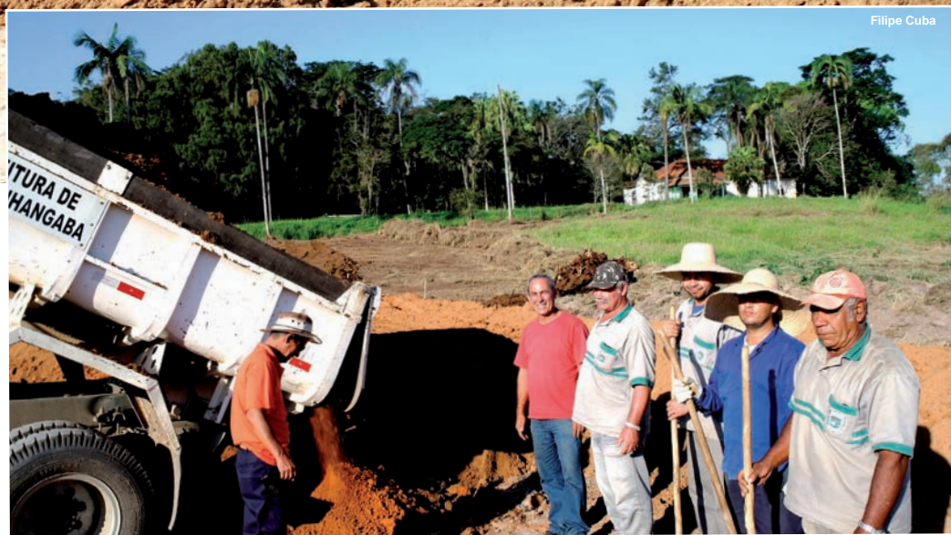
Equipe da Prefeitura que está fazendo o serviço de terraplanagem da portaria
