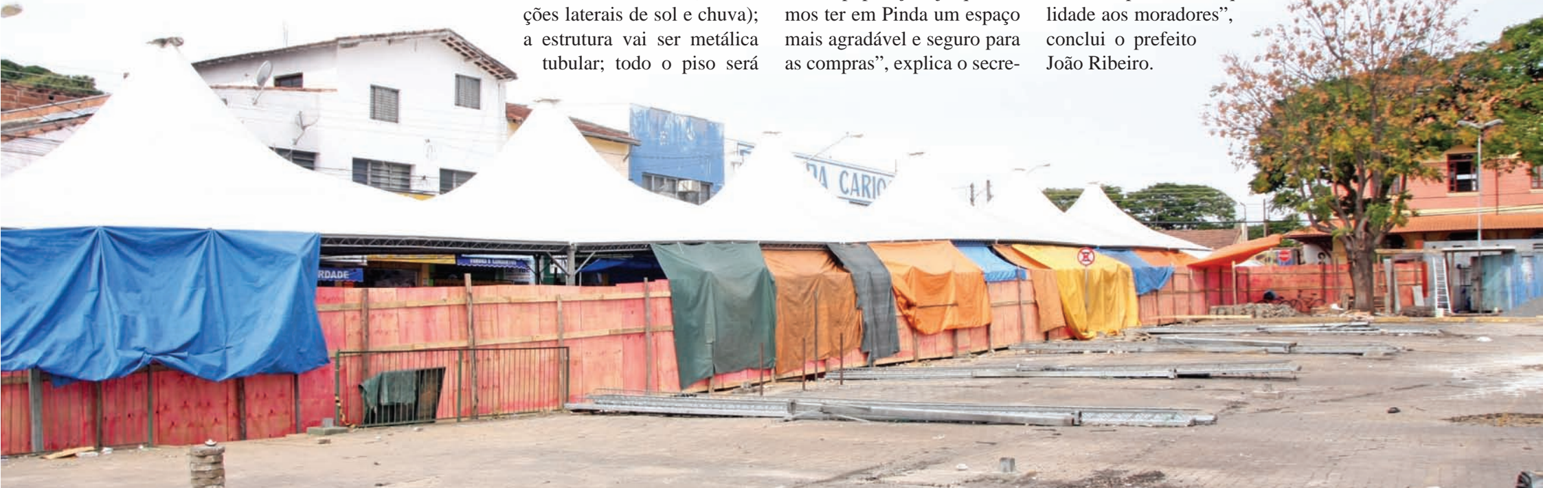
Projeto da cobertura acrescenta uma série de melhoramentos à Praça da Liberdade, como a substituição do piso e a readaptação das rampas de acesso
