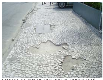
CALÇADA DA RUA DR GUSTAVO DE GODOY ESTÁ COM MUITOS BURACOS
