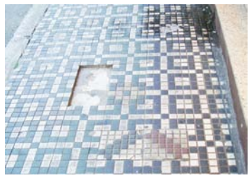
BURACO NA CALÇADA DA RUA DOS ANDRADAS
