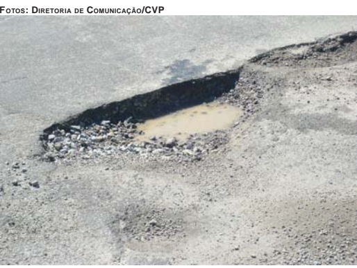
VEREADOR SOLICITA À PREFEITURA OS REPAROS NO ASFALTO NA SAÍDA DA PONTE DO CARANGOLA
