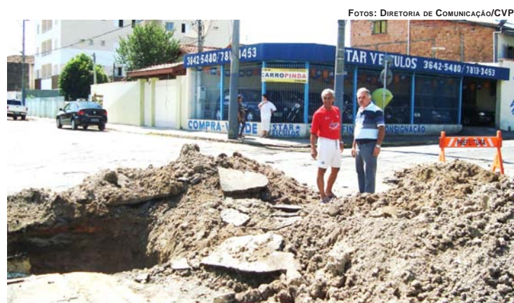
DR. JAIR ROMA ACOMPANHA OBRAS NA ESQUINA DAS RUAS FREDERICO MACHADO E VITORIO BASSO
