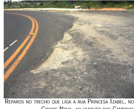
REPAROS NO TRECHO QUE LIGA A RUA PRINCESA ISABEL, NO CIDADE NOVA, AO VIADUTO DAS CAMPINAS
