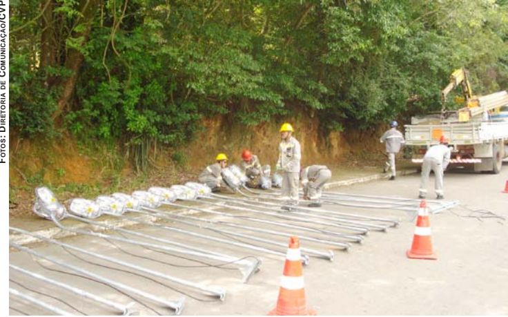
POSTES COM TRANSFORMADORES, SUPORTES E LUMINÁRIAS SÃO TROCADOS NA AVENIDA DR. ANTONIO PINHEIRO JUNIOR
