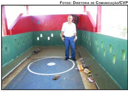
QUADRA POLIESPORTIVA E A RAIA DE MALHA NO BAIRRO DAS CAMPINAS APRESENTAM LIXO, DANIFICAÇÕES E ABANDONO
