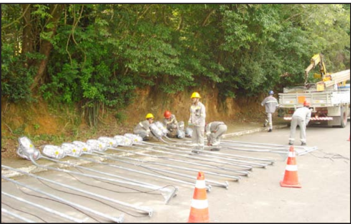
POSTES COM TRANSFORMADORES, SUPORTES E LUMINARIAS SÃO TROCADOS NA AVENIDA DR. ANTONIO PINHEIRO JUNIOR
