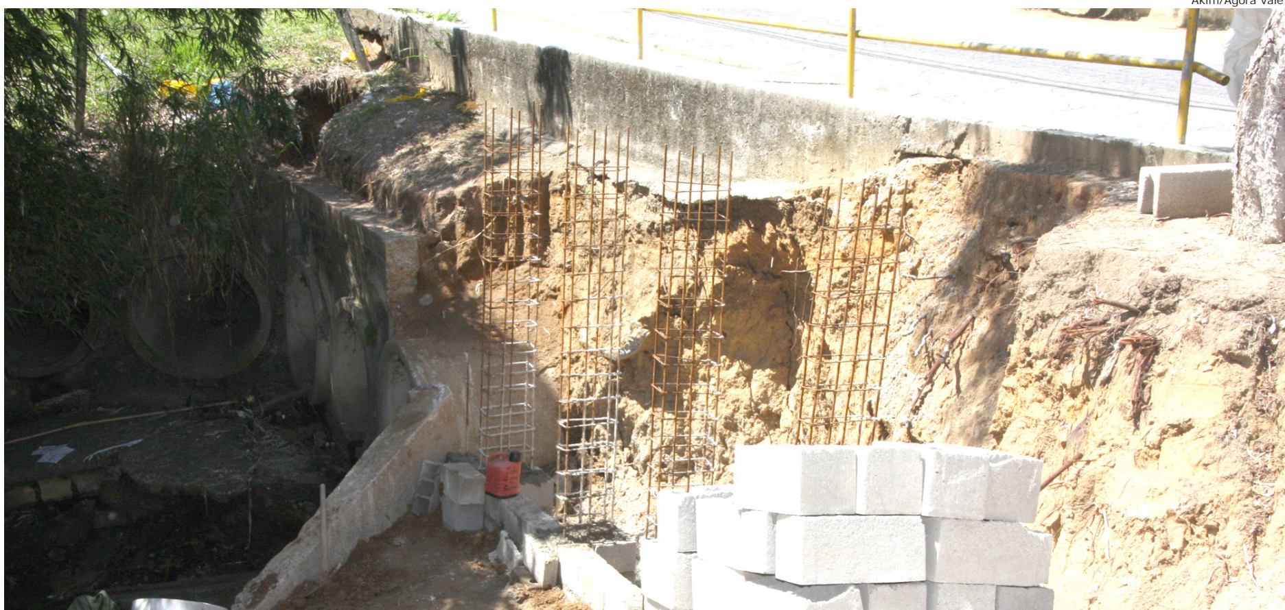
As obras da construção do muro começaram há duas semanas e o término está previsto para os próximos 25 dias úteis
