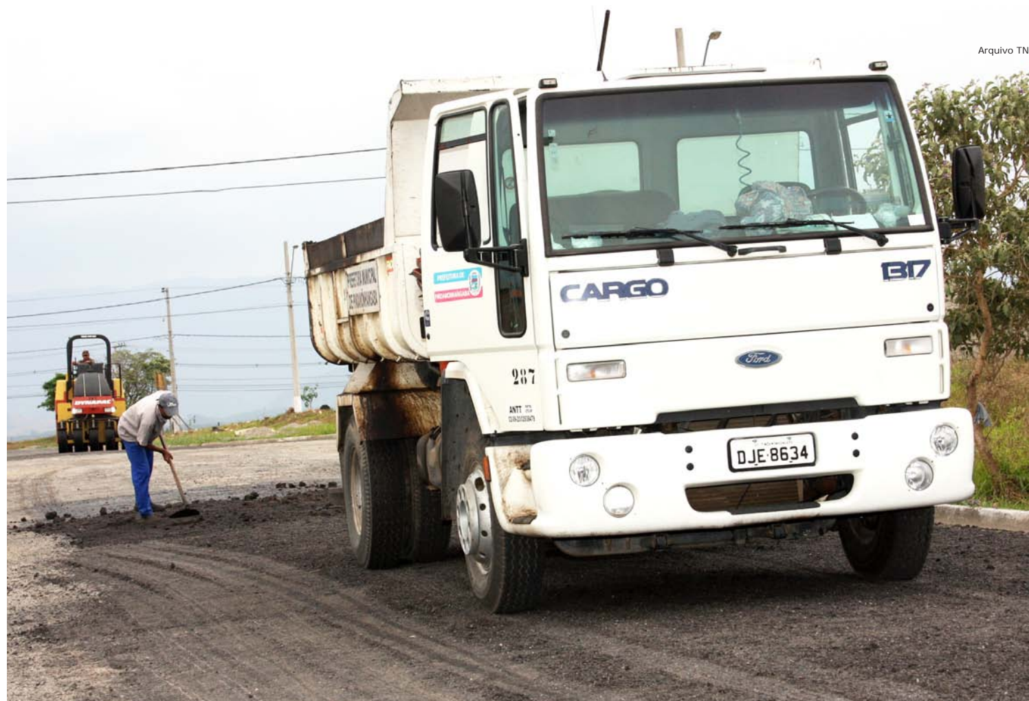
Funcionários da Prefeitura fazem manutenção em piso asfáltico de rua no Parque das Palmeiras
